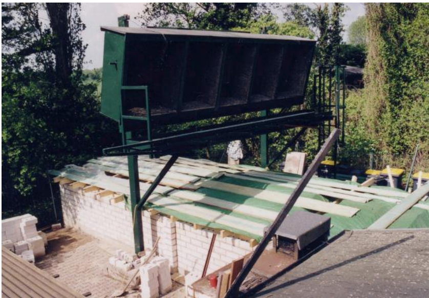
Bau der Luftgewehrbahn: Im Mai hatte das Bauwerk bereits Gestalt angenommen, äußere Form und Abmessungen waren sichtbar
