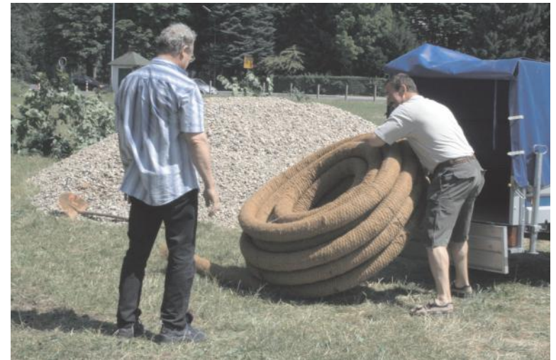
Arbeiten an der Schützenwiese: Jürgen Huhn und Hartmut Albert beim Ausladen der Drainagerohre
