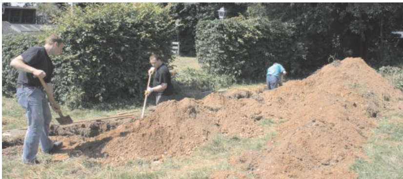
Franz Folter beim Ausheben der Gräben mit dem kleinen Bagger. Thomas Bruckmann, Christian Borkowski und Herbert Bruckmann beim Glätten der Grabensohle
